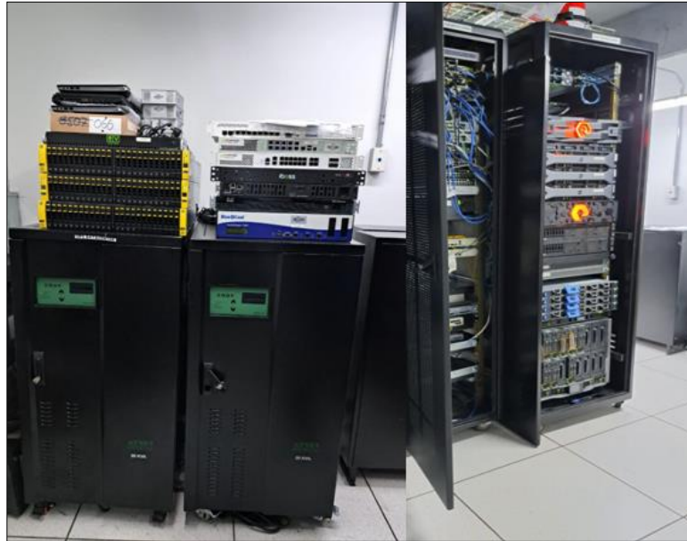
Figura 1. UPS y Servidores Data Center Piso 12.
