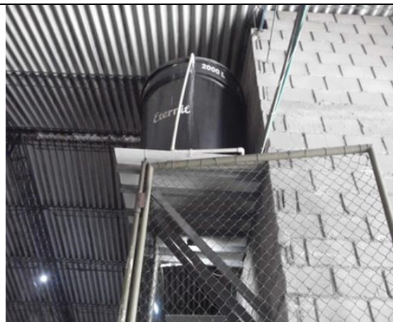
Tanque de reserva de 2000 m 3
