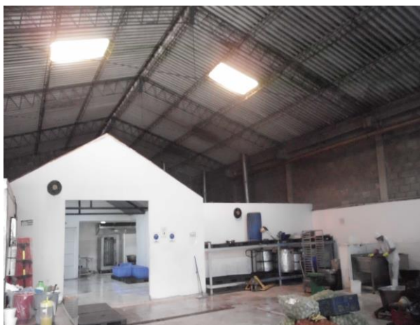
Poca ventilación en la bodega
