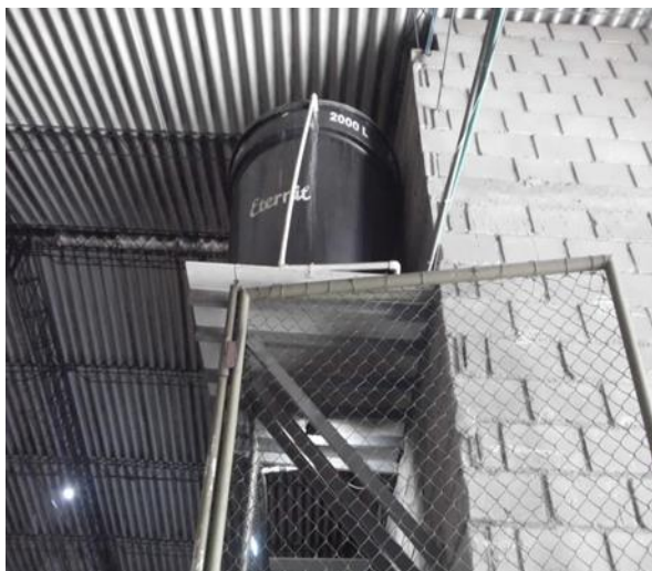
Tanque de almacenamiento
