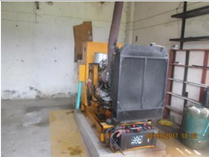
Planta eléctrica antigua
