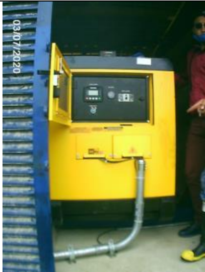
Planta eléctrica de 45 kVA en bocatoma rio Tuta
