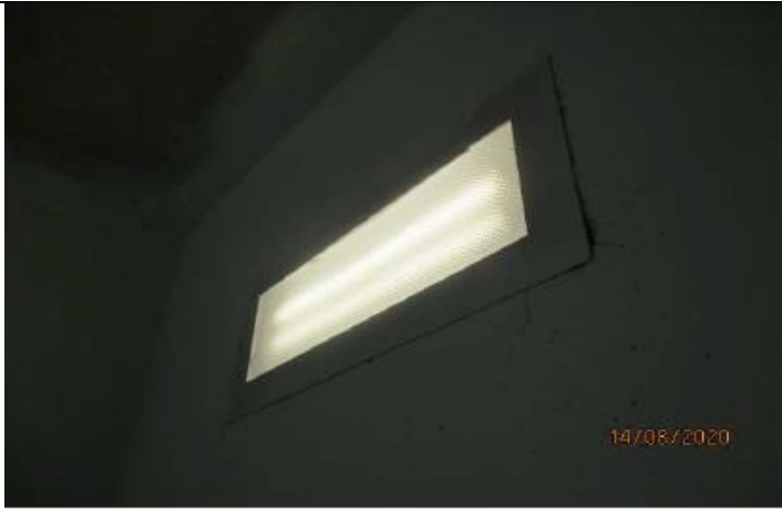
Suministro e instalacion de luminarias internas celdas UTE.
