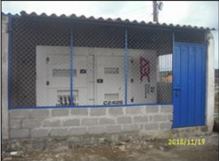
Nueva planta eléctrica de 300 kVA cabinada
