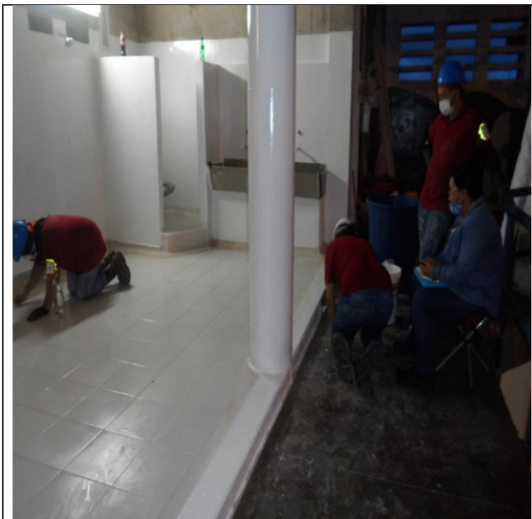
ENCHAPE BALDOSA ANTIDESLIZANTE DE BAÑOS
