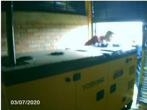
Planta eléctrica de 45 kVA en bocatoma La Laguna
