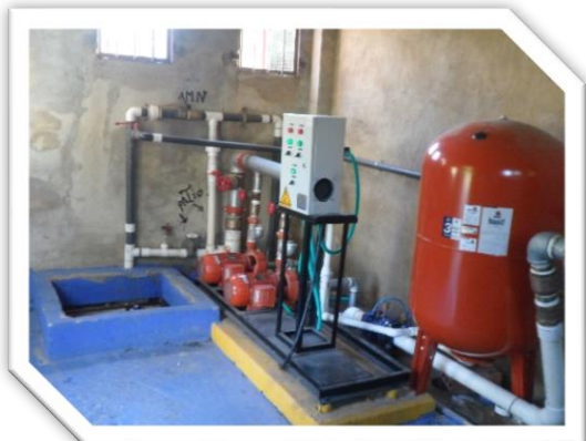
Sistema de Bombeo
