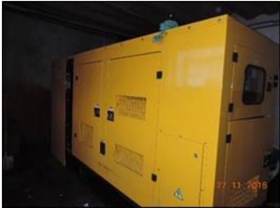
Nueva planta eléctrica de 300 kVA cabinada
