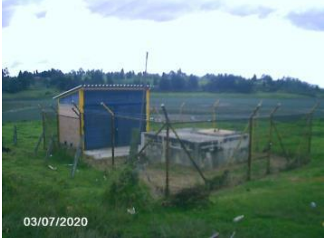
Nuevo cuarto para planta eléctrica bocatoma de agua Laguna
