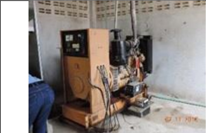
Planta eléctrica antigua
