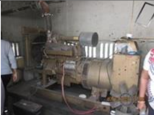
Planta eléctrica antigua
