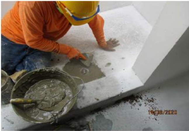
Suministro e instalacion de regillas zona UTE
