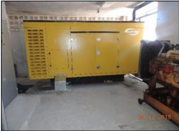
Nueva planta eléctrica de 300 kVA cabinada
