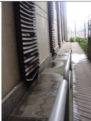
Fugas en las redes de agua potable y sanitaria en la estructura III, que ocasionan infiltración de agua en el terreno. (Visita realizada por la CGR el 2 de noviembre de 2017)
