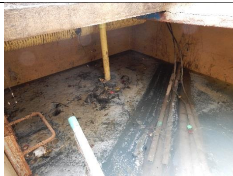
Estado del pozo construido para evacuación de aguas del foso del ascensor en las torres C y D: se observa presencia de tubería de agua residual e inundado con agua residual
