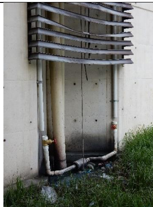
Estado de las redes de agua potable y sanitaria en la estructura III, contiguo a los ascensores de las torres A y B. Se observan fugas en las redes que ocasionan infiltración de agua en el terreno. (Visita realizada por la CGR el 23 de noviembre de 2018)
