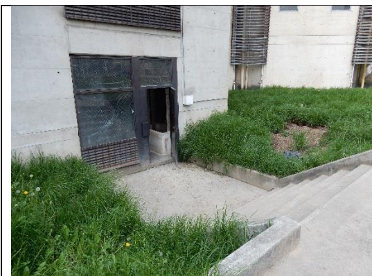
Se observa el primer nivel de los ascensores a una cota inferior al del nivel del terreno adyacente
