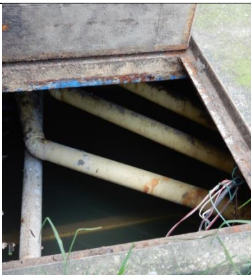
Estado del pozo construido para evacuación de aguas de los fosos de los ascensores de las torres A y B: se observa inundado y existencia de tuberías de aguas residuales
