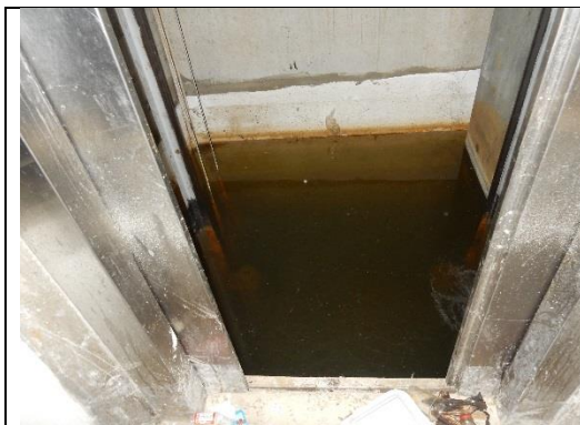
Fosos de los ascensores inundados (Visita del 23 de noviembre de 2018)
