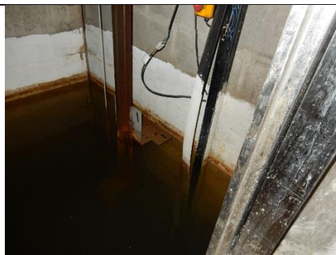
Fosos de los ascensores inundados (Visita del 23 de noviembre de 2018)
